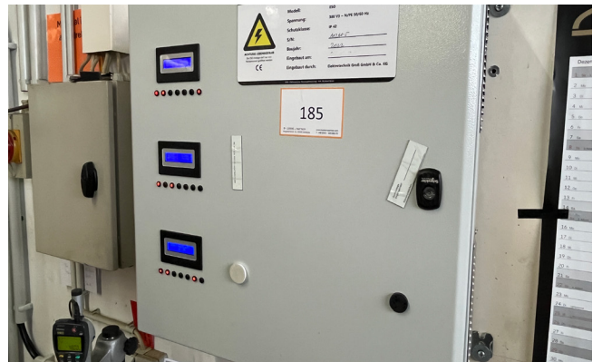
Pos. 185 1 Strom-Optimierungsanlage ESO, Bj. 2022 1 Power optimization system ESO, YOM 2022
